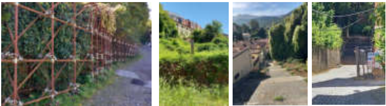
Muro di contenimento puntellato su Via Borgo Rivera
